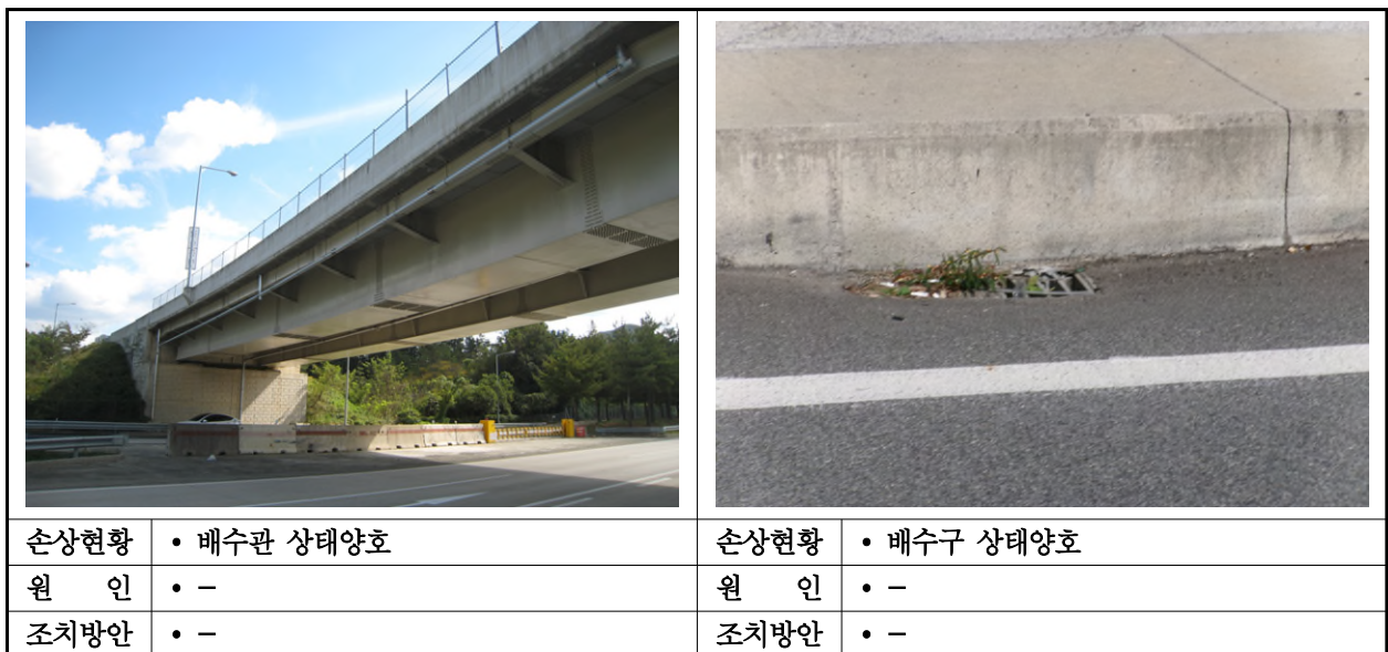
【사진 13.3.20】 배수시설 손상현황
